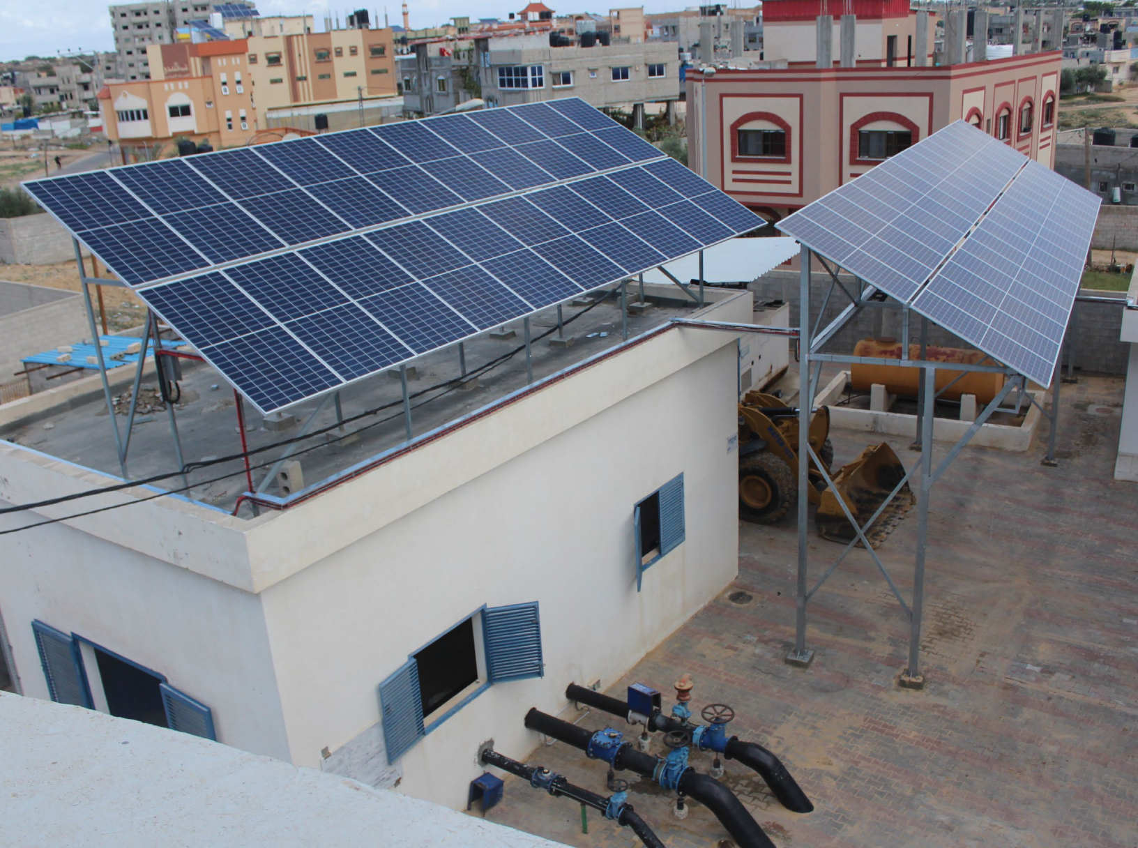
Канада-Уэлл, Рафах, Газа, 2019 год. В рамках поддержки Компании по водоснабжению прибрежных муниципалитетов МККК установил солнечные батареи, систему чистого измерения показаний и отдельную линию электропередачи, чтобы повысить оперативную устойчивость подачи воды и снизить эксплуатационные расходы одного из важнейших объектов общественного водоснабжения. © Н. Mhanna/ICRC.
