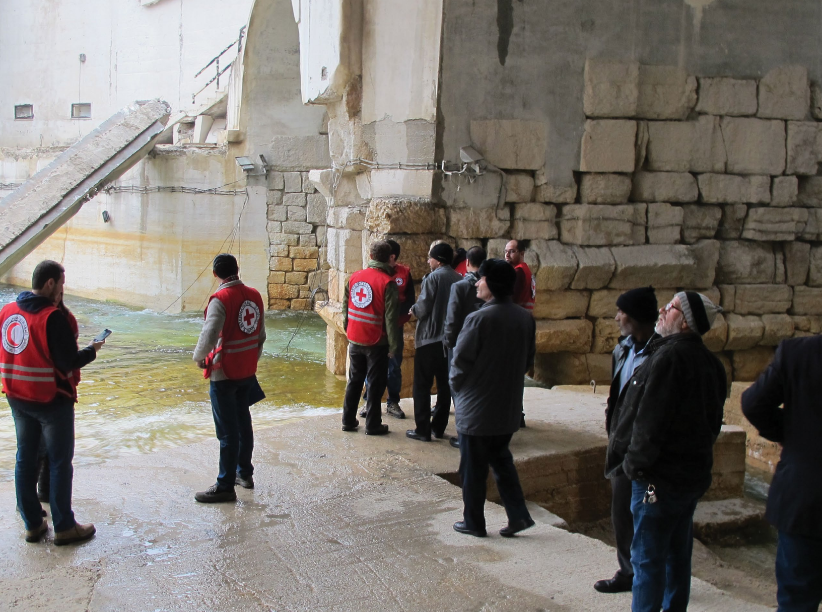
Обследование поврежденного каптажа источника Фигех — основного источника питьевой воды для Дамаска и ряда его пригородов, которым пользуются около 5 миллионов жителей и внутренне перемещенных лиц в Сирии. © L. Khalil/ICRC.
