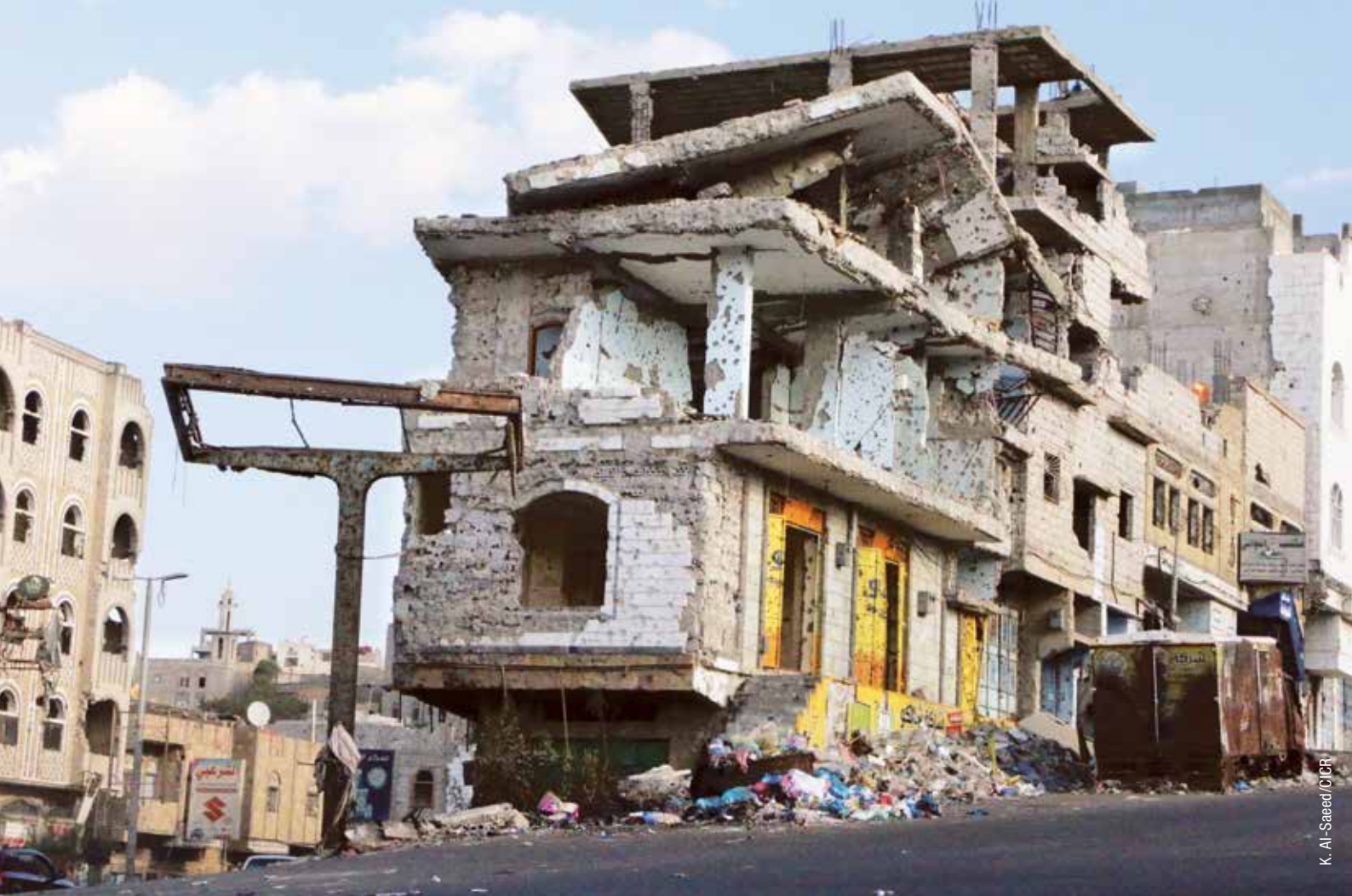
Bâtiment civil partiellement détruit dans la ville de Taïz, dévastée par la guerre. Décembre 2016.
